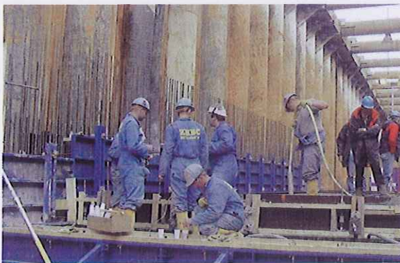
Acabado superficial en recinto de pilotes
